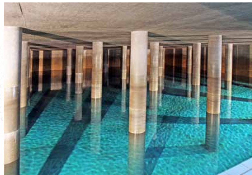
Der Hochbehälter oberhalb von Burgberg fasst 9000 Kubikmeter Wasser, die von dort aus im gesamten Allgäu verteilt werden.
